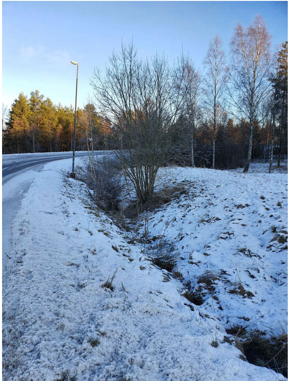
Vägdike som även hanterar dagvatten från ledningar i Kapellvägen
